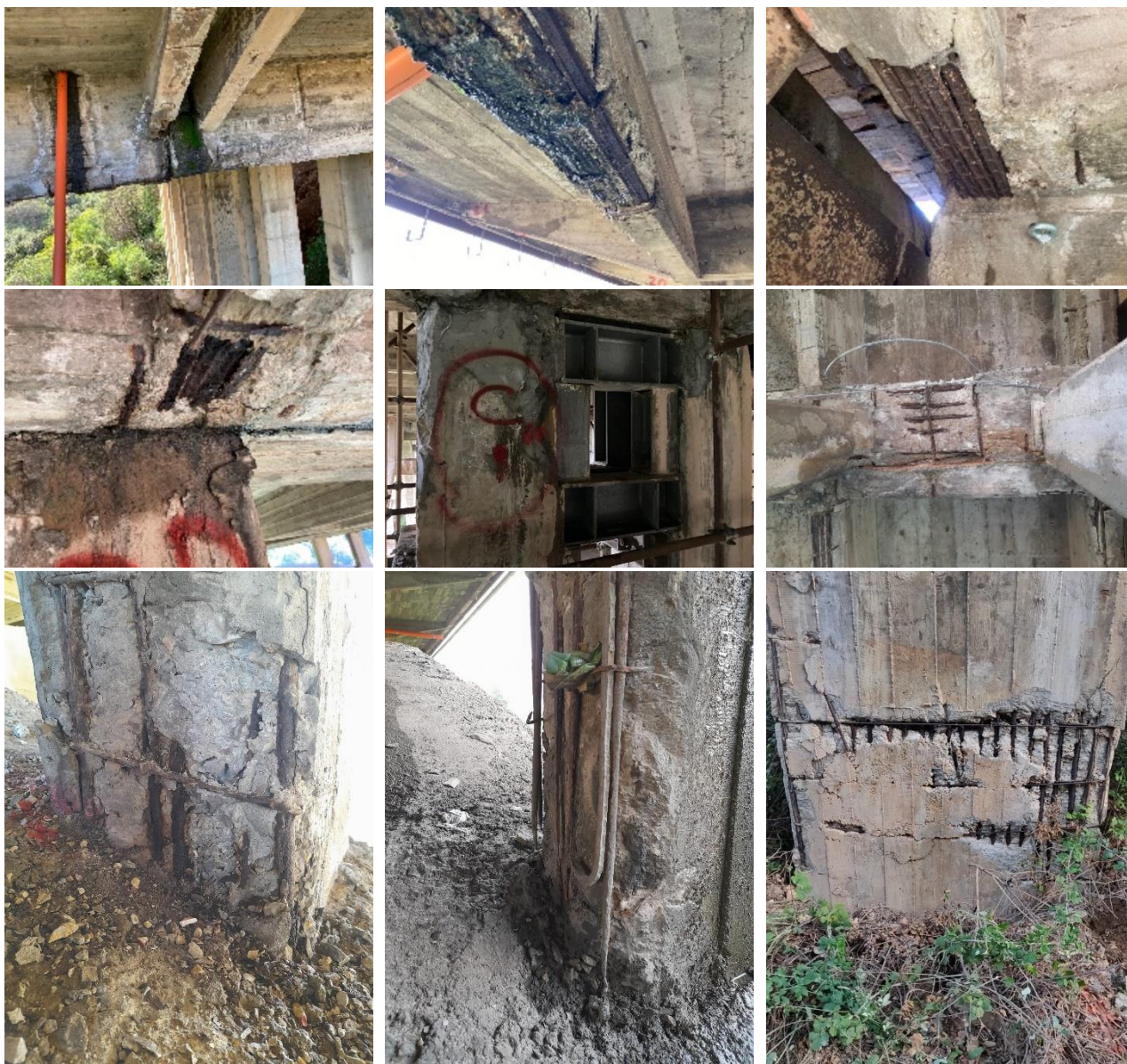
Figura 11 – Alcuni degradi riscontrati nel corso del 2021
